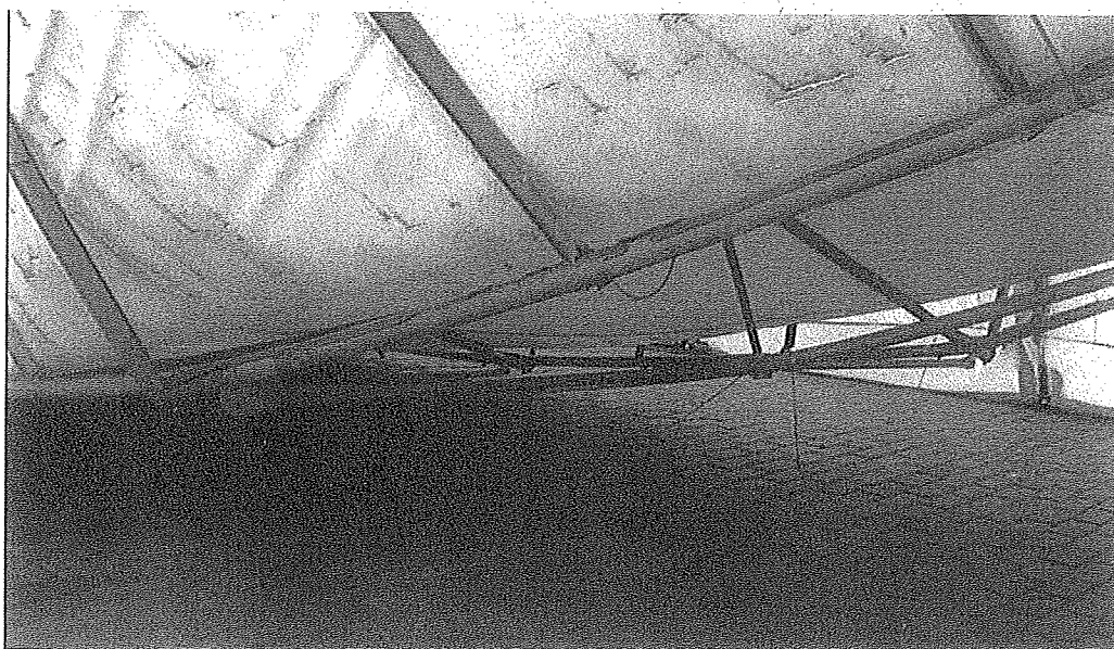
28 listopad 2025 Intensywne opady śniegu spowodowały uszkodzenie namiotu świetlicy spotkań i integracji działkowców
