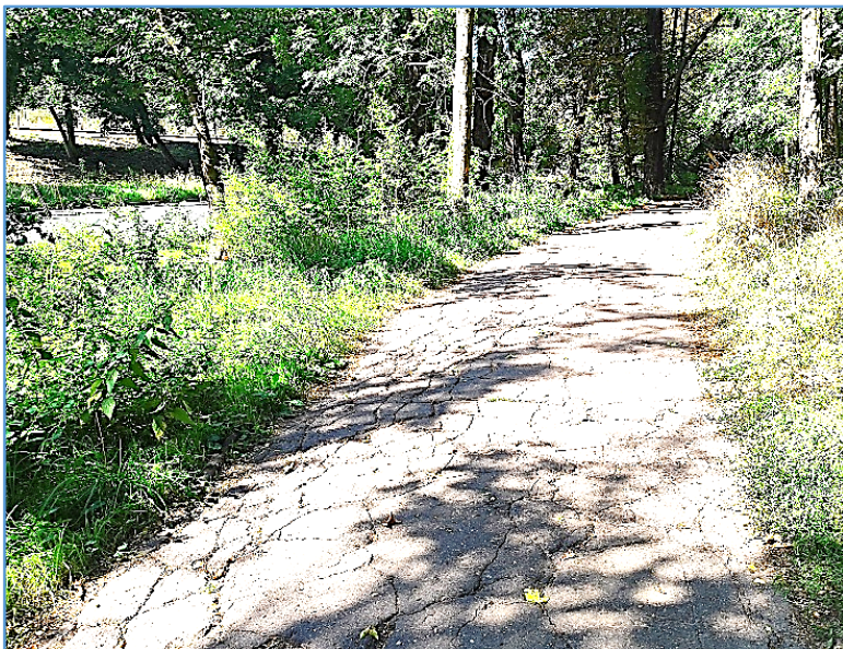
spękania warstwy bitumicznej
