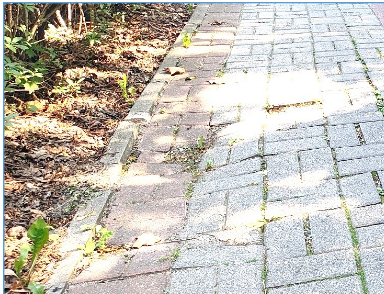
osiadanie kostek betonowych
