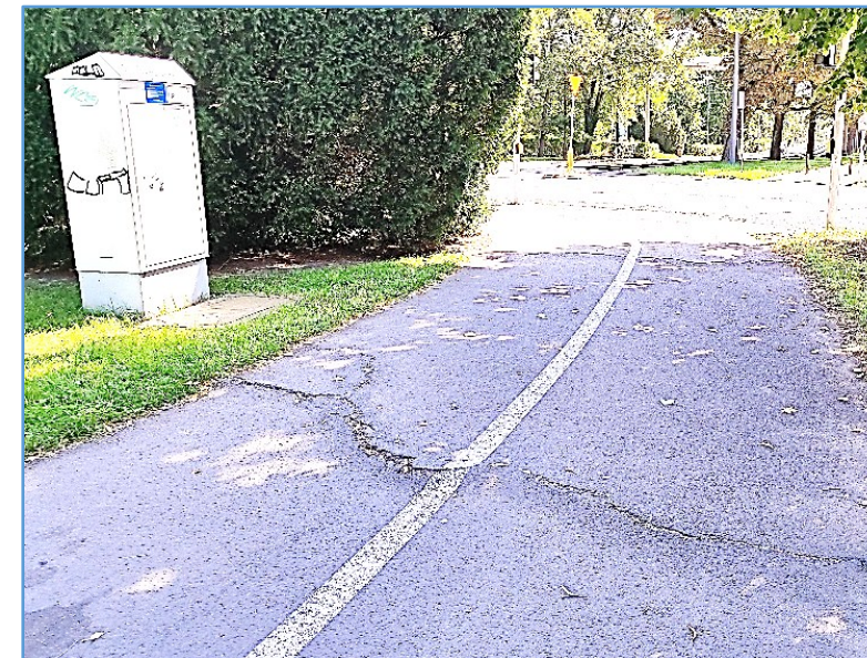
wypiętrzona nawierzchnia spowodowana korzeniami lub instalacjami technicznymi
