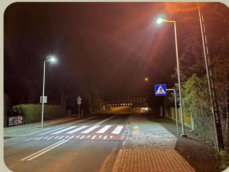
doświetlenie przejścia dla pieszych ul. Dworcowa Kórnik
